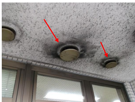
＜ふじみ野分署、吹出口汚れ＞
