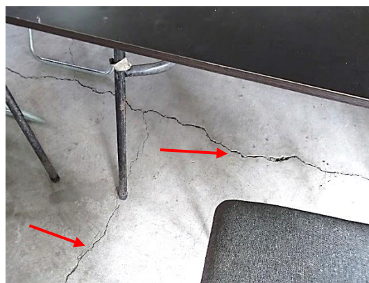
<三芳町消防団第5分団、床のひび割れ>
