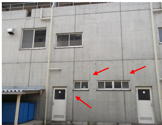
＜東消防署 B 棟、外壁ひび割れ＞
