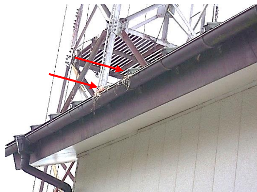
<ふじみ野消防団第10分団、屋根樋>
