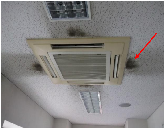
＜三芳分署、エアコン吹出口＞
