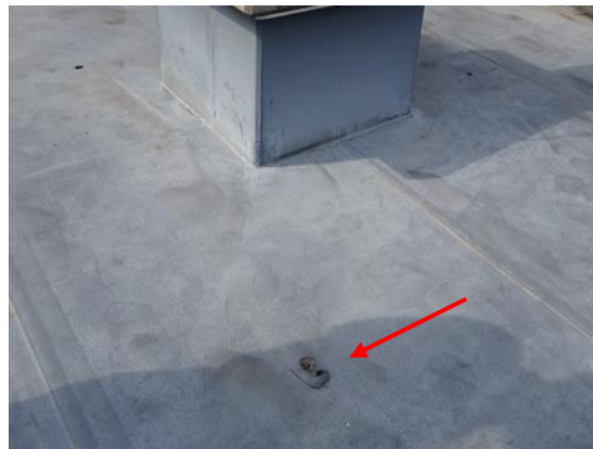
＜東消防署、屋上防水穴＞
