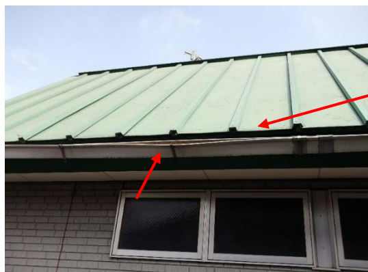
<ふじみ野消防団第5分団、屋根樋>
